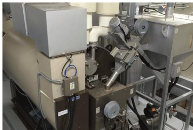
▼本邦初公開？木材ペレットボイラーです
