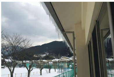
▼施設北側（小学校側）のつららです
